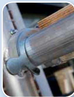
Podlahy sú zabezpečené proti podfúknutiu vetrom
